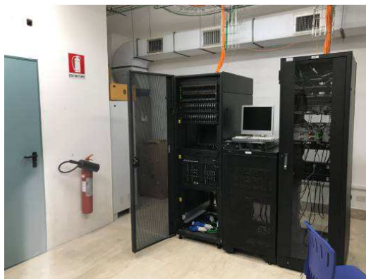
Sala server PT
