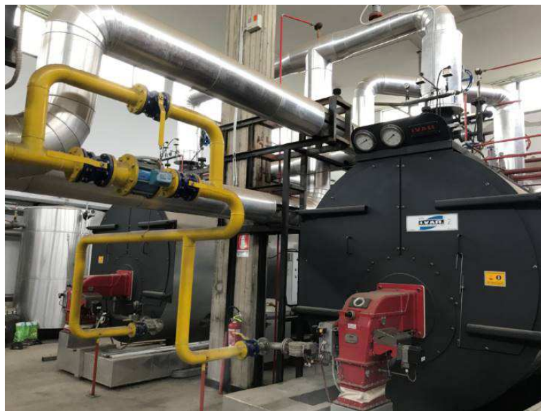
Centrale termica teleriscaldamento
