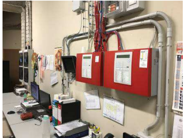
Centraline controllo allarmi antincendio
