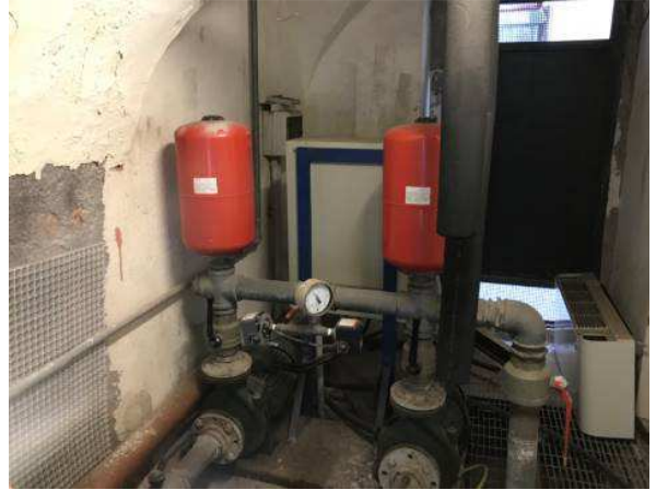
Stazione di pompaggio antincendio
