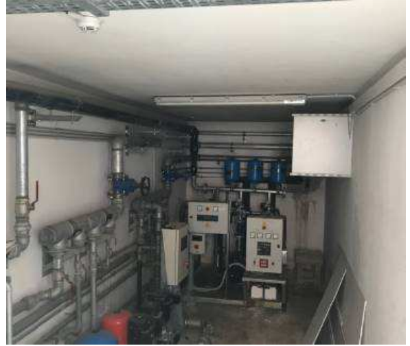
Stazione di pompaggio antincendio
