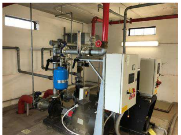
Stazione di pompaggio antincendio
