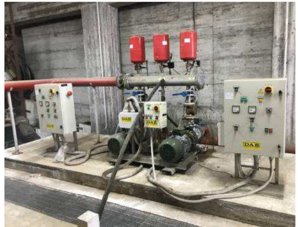
Stazione di pompaggio antincendio
