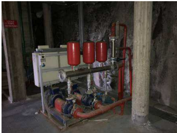
Stazione di pompaggio antincendio
