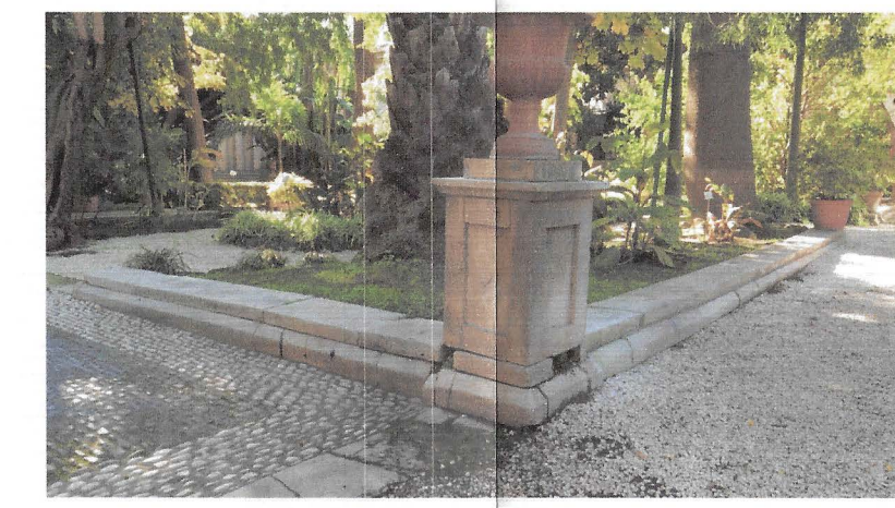
foto 2_ restauro e integrazione parti mancanti delle colonne in pietra arenaria (vedi voce: N.P.01)
