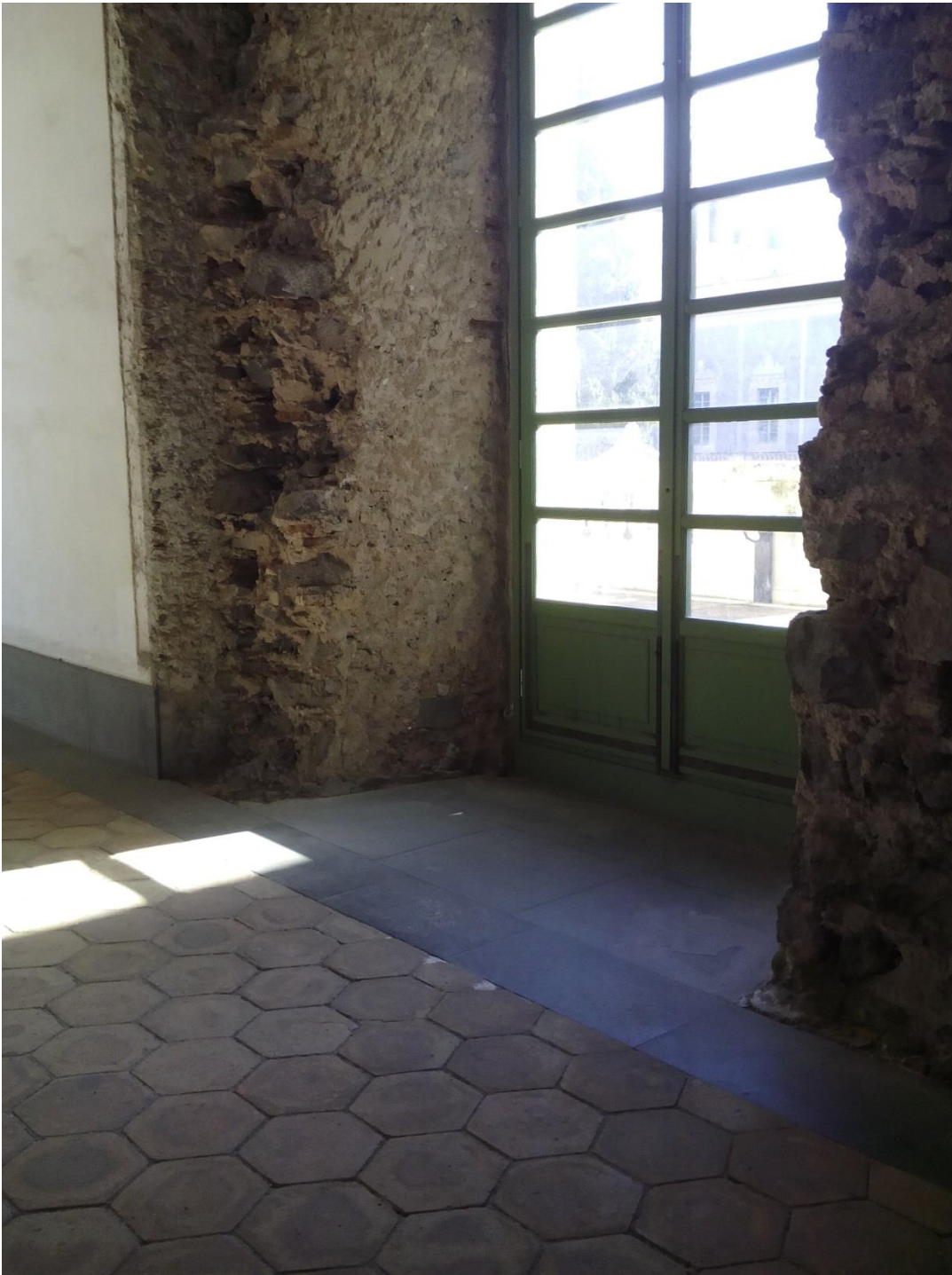
Figura 18 – infissi esterni da revisionare e verniciare
