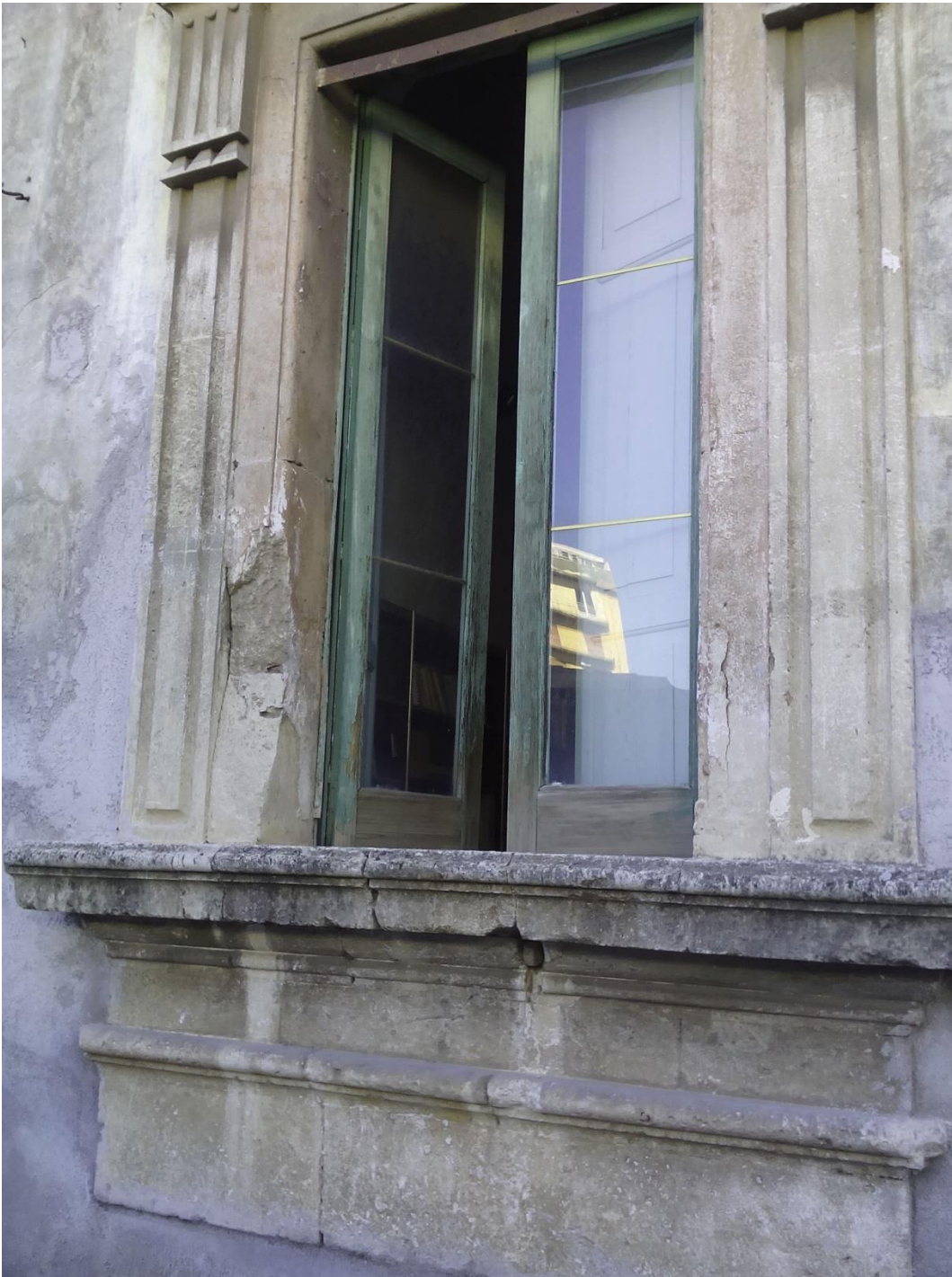
Figura 17 – infissi esterni da sostituire
