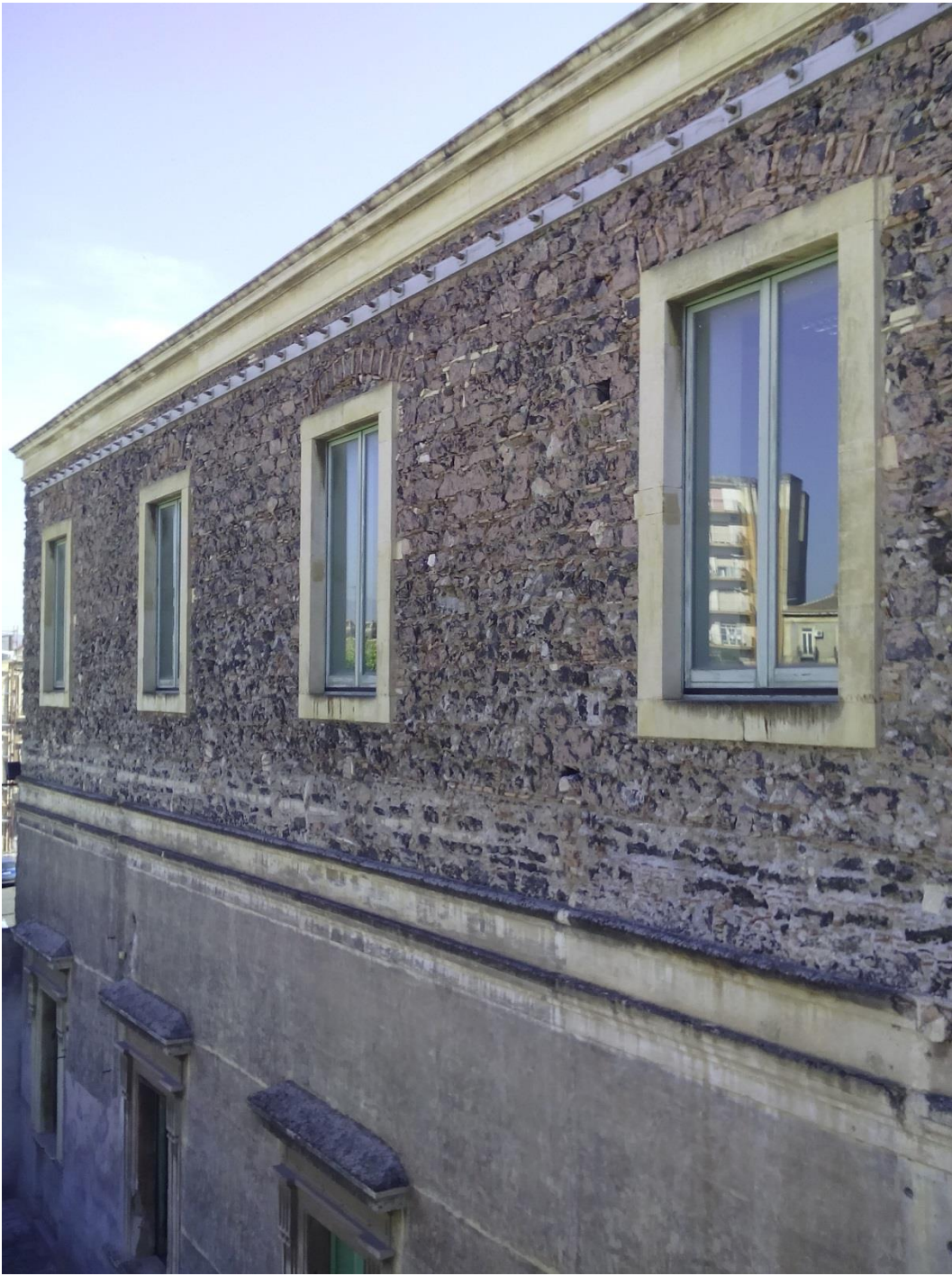
Figura 19 – infissi esterni da revisionare e verniciare
