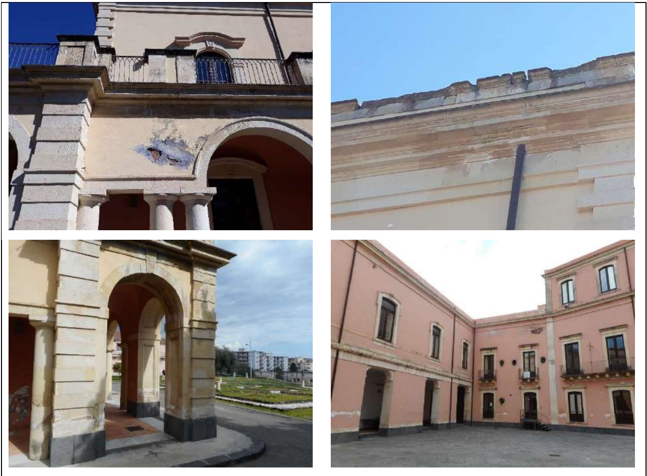
Figura 8. Alcuni dettagli delle finiture ammalorate: si distinguono lacune, mancanze, efflorescenze, erosione, patina biologica.
