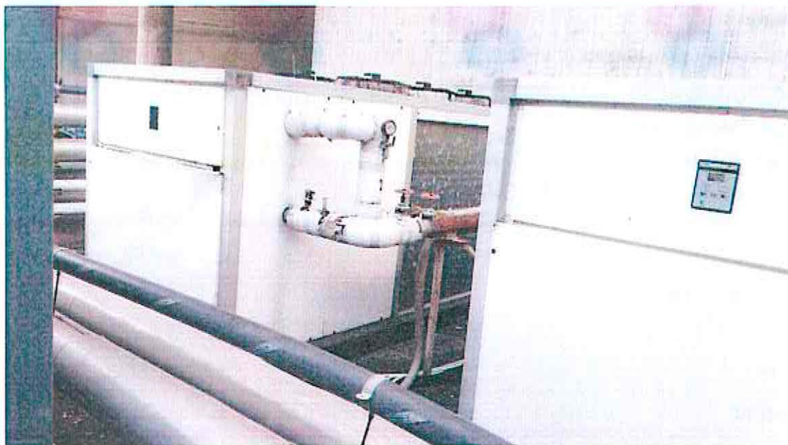
(il gruppo da sostituire è quello di sinistra)
